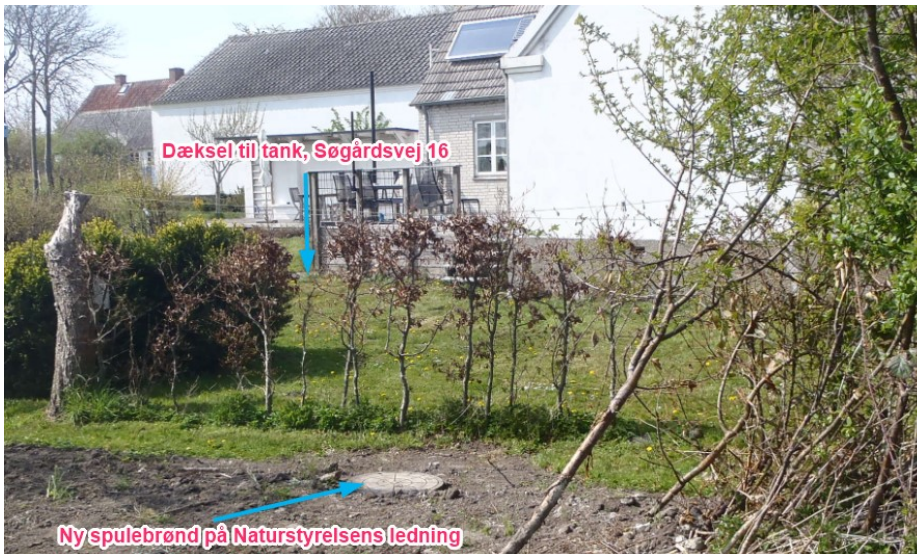
Figur 12. Ny rensebrønd (spulebrønd) på Naturstyrelsens dræn og brønddæksel ved bundfældningstank på Søgårdsvej 16.
