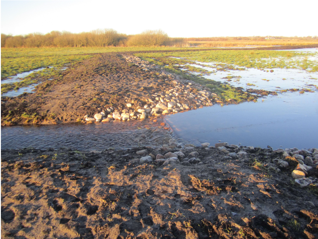
Figur 10 PE-plade etableret i udløb fra sø. Her dog med et fald henover PE-pladen
